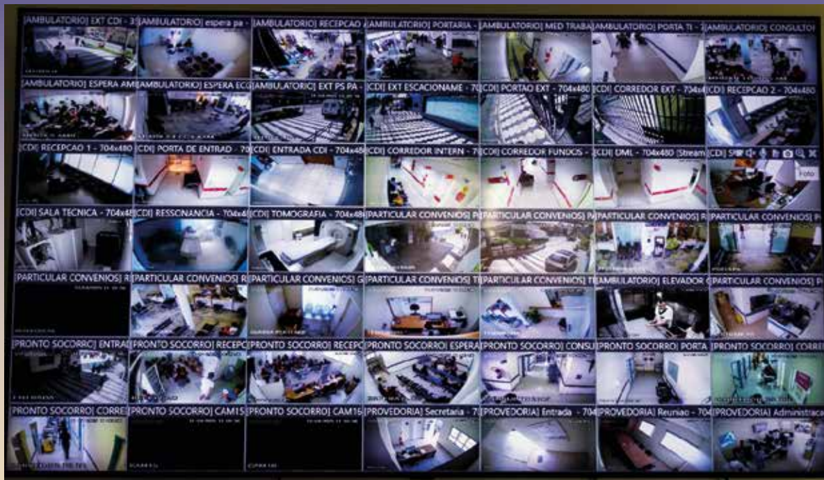
Instalação de uma central de monitoramento das áreas internas do hospital
